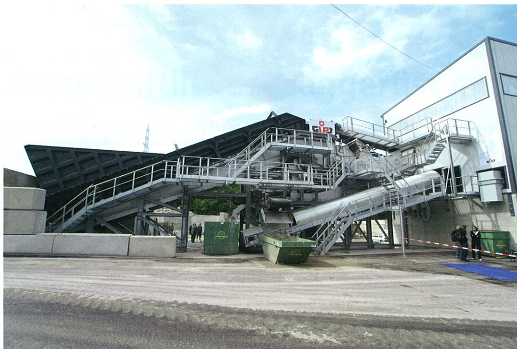
La Gravière de la Claie-aux-Moines a inauguré sa nouvelle halle de recyclage de béton. L'installation permet notamment de trier automatiquement les éléments indésirables présents dans les gravats de démolition.
